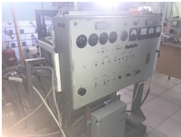
Рисунок 4.3 – Блок системы автоматического управления газодизельной установкой
